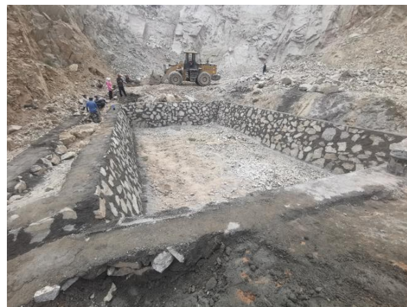
排土场雨水收集池
